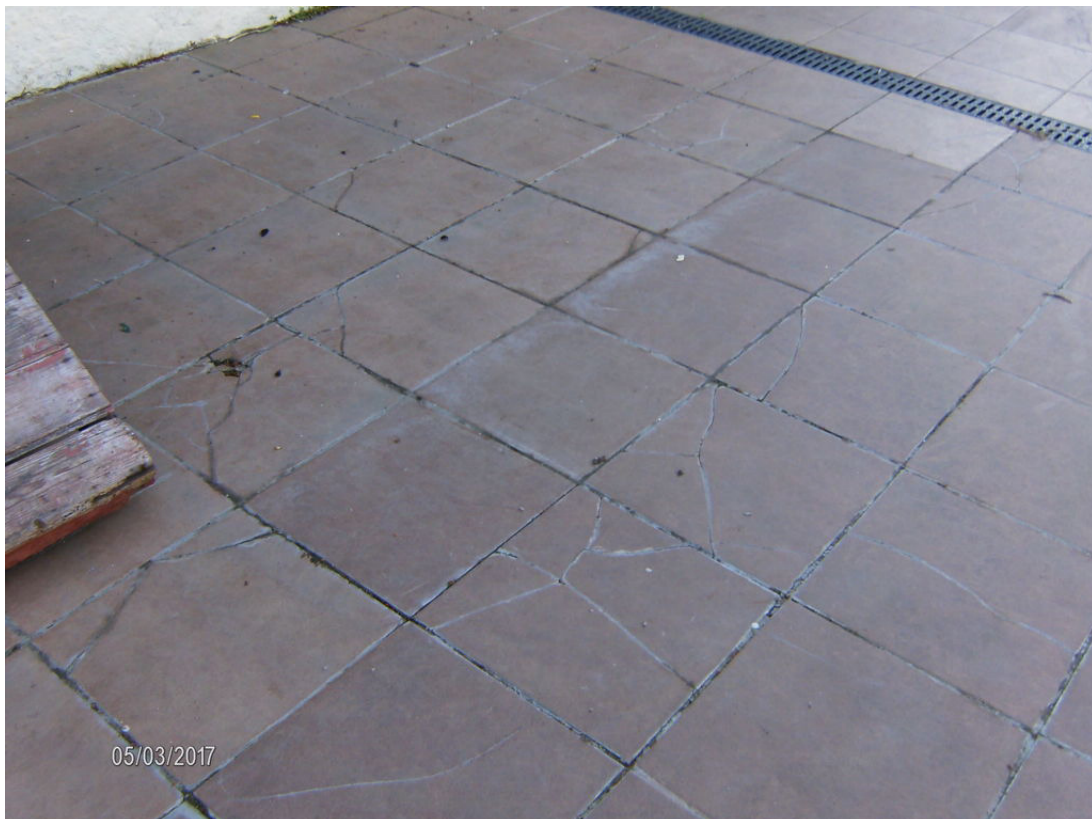
Paviment trencat gres terrassa
